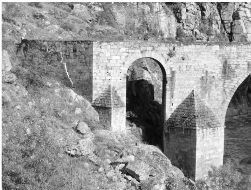
Figura 8. Ojo de la margen izquierda del puente de Barba del Puerco. Este arco fue volado en marzo de 1812 y no fue reconstruido hasta 1844.
